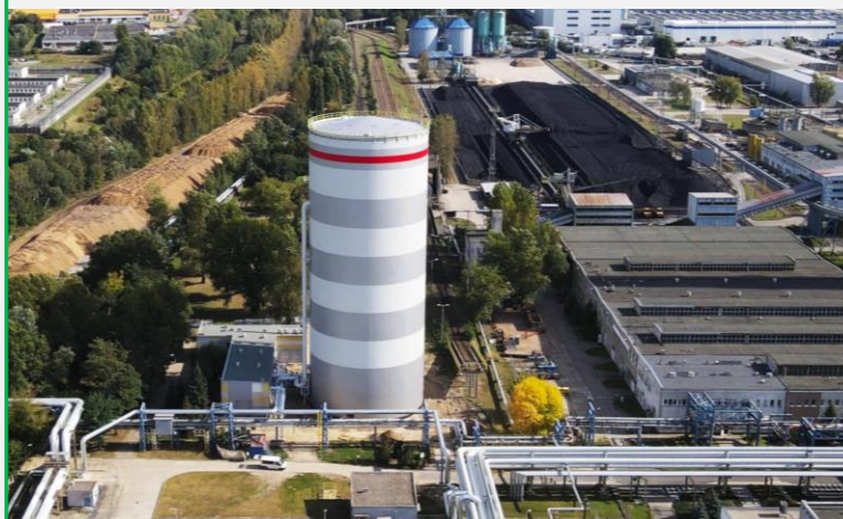
Veolia Energia Poznań - akumulator ciepła
