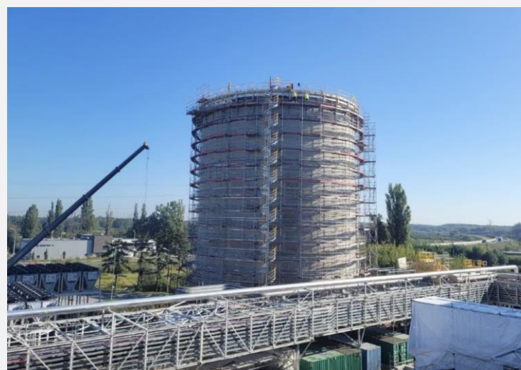
Magazyn ciepła Na terenie EC Czechnica-2 (fot. PGE Energia Ciepła)
