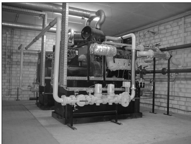
Rysunek 5-7: Elektrociepłownia blokowa z regulowanym odcinkiem przepływu gazu (rury jasne); Zdjęcie: MT-Energie-GmbH
