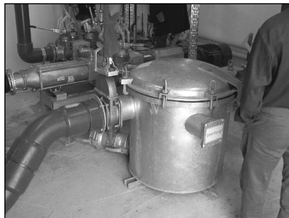
Ilustracja 3-29: Oddzielacz ciał ciężkich w rurociągu; zdjęcie: Institut für Energetik i Umwelt gGmbH
