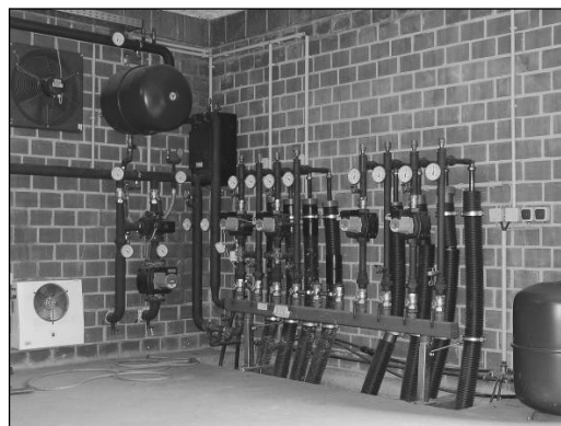
Rysunek 5-6: Rozdzielacz ciepła; zdjęcie: MT-Energie-GmbH
