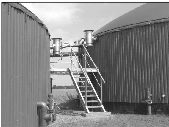
Ilustracja 3-28: Pomost roboczy między dwoma zbiornikami z rurociągami i zabezpieczeniami ciśnieniowymi; Zdjęcie: MT-Energie GmbH
